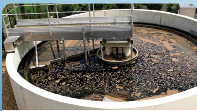
Decantador Fangos Ind. Alimentaria 20 m³/h
