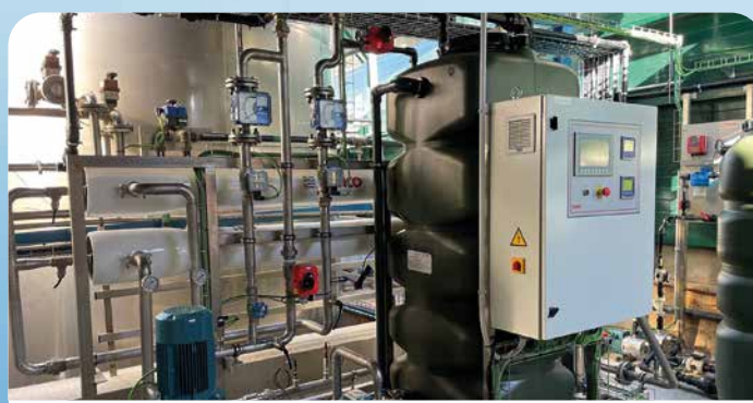
Reciclaje rechazo ósmosis inversa con Nanofiltración 7,5 m³/h
