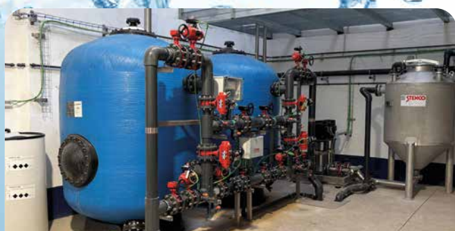
Filtración Industria Láctea 40 m³/h
