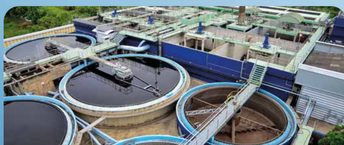
EDAR Planta Química 150 m 3 /h
