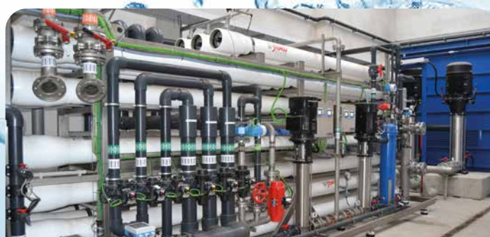
Ósmosis Inversa 95 m³/h Industria Química
